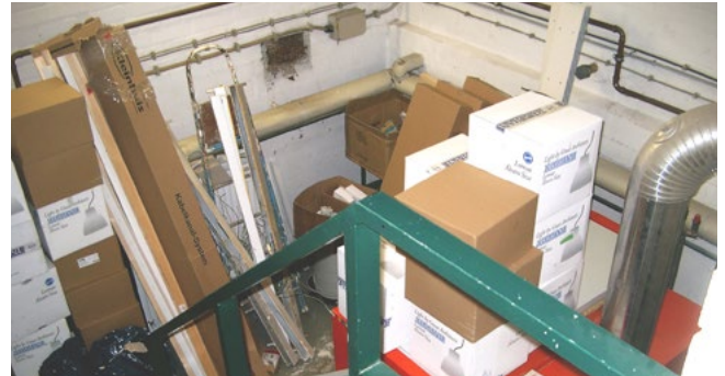
Bei einer Begehung fällt alles auf: Auch ein großer Heizungskeller ist kein Abstellraum. Brennbare Gegenstände haben darin nichts zu suchen.
