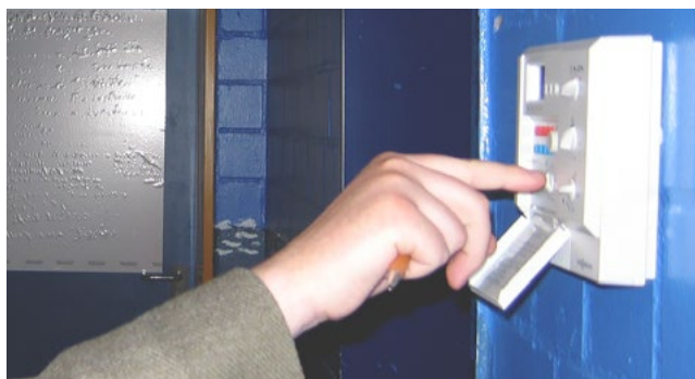
Die Einstellung der Heizzeiten ist je nach Regelungstechnik – vorsichtig gesagt – „anspruchsvoll“. Aber es lohnt sich – durch eine optimierte Einstellung der Heizzeiten lassen sich durchaus 15 % an Energie einsparen.
