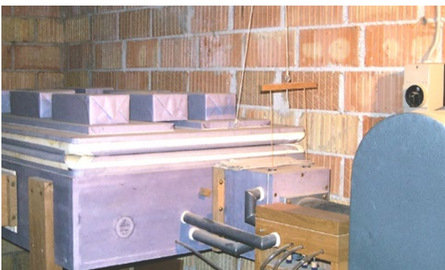
Der Grund für zu trockene Raumluftwerte ist häufig, dass mit zu hohem Außenluftanteil geheizt wird. Ursache kann eine nicht vollständig geschlossene Umluftklappe sein oder – wie in diesem Fall – das aus dem Kirchenraum in den Keller verbannte Orgelgebläse. Im Ergebnis gelangt kalte Außenluft in den Kirchenraum, erwärmt sich dort und verringert so die Raumluftfeuchte.
