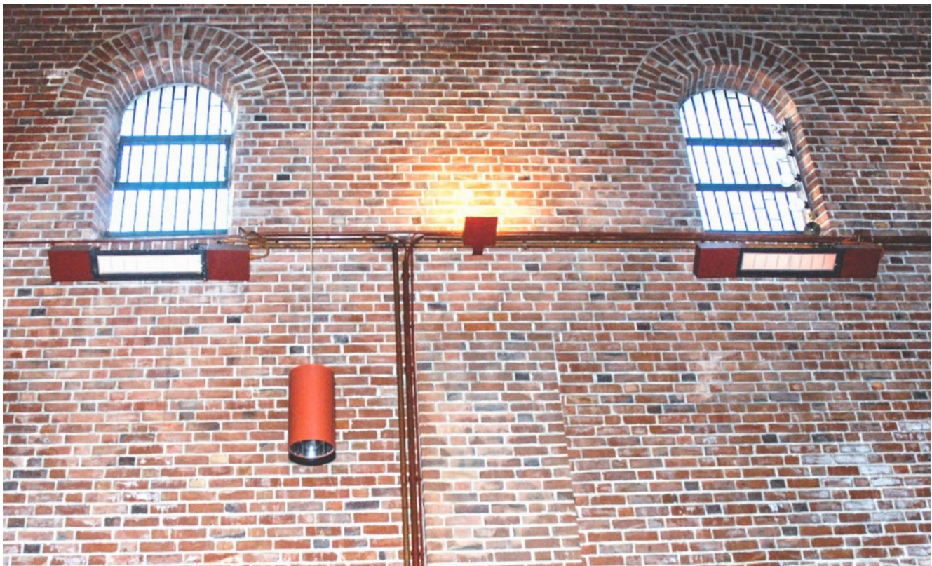
Vor dem Einsatz von Hellstrahlern ohne gesicherte Feuchteabfuhr kann man gar nicht deutlich genug warnen. Der entstehende Wasserdampf schlägt sich in der Kirche an den kalten Bauteilen nieder und kann zu erheblichen Bauschäden führen.
