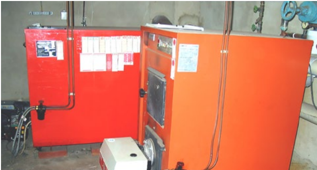
Zwei Heizkessel nebeneinander. Einer versorgt die Kirche, der andere das benachbarte Gemeindezentrum. Eigentlich der Idealfall, um die Kessel zu einem zusammenzufassen. Die Vorteile: Die Anschaffung ist preiswerter, der Betrieb effektiver und die Wartungskosten sind niedriger.
